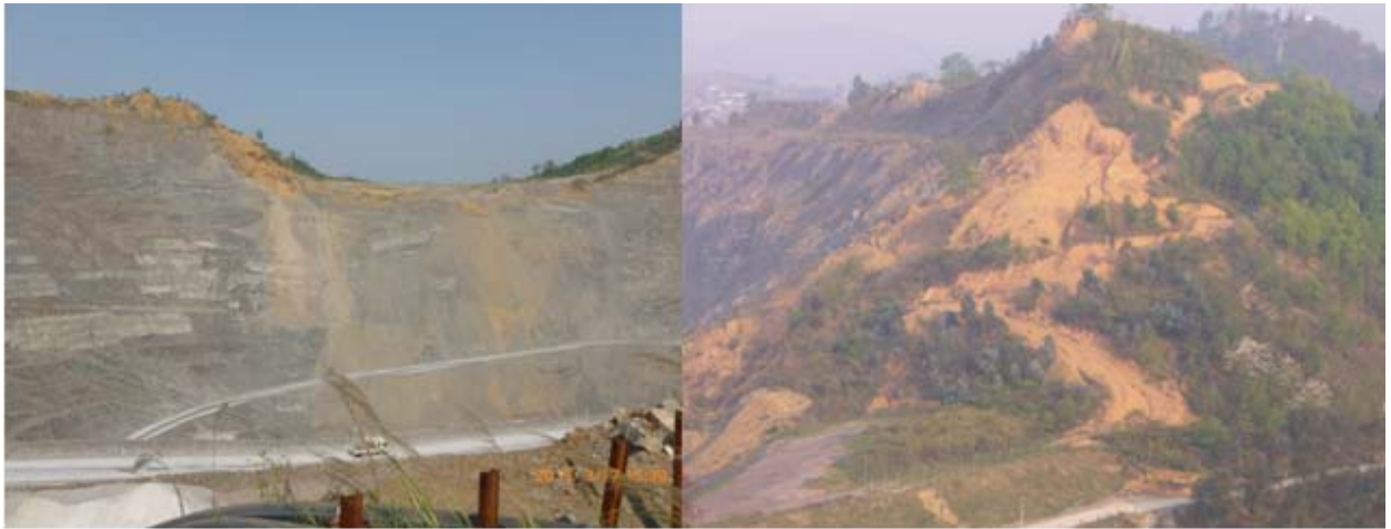
..... 图片 4-2 露天边坡滑坡 ..... 图片 4-3 露天边坡坡顶强风化岩层滑坡 .....
